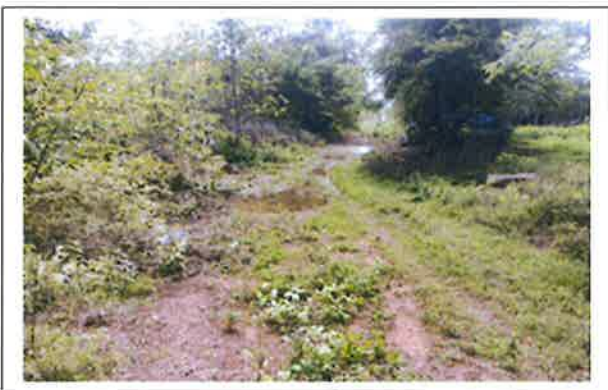
ปรับปรุงถนนลูกรังสู่แหล่งการเกษตร หมู่ที่ ๘ เส้นข้างคอกหมูนายไพบูล ราชสิงห์
